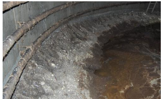
Abb. 4: Ablagerungen (Kies, Sand, Steine)
