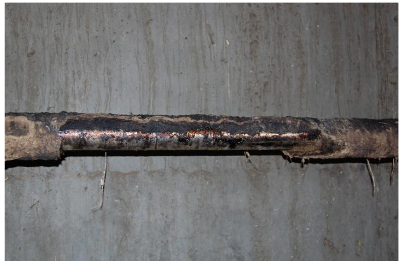
Abb. 2: mit faserigem Material verklebte Heizungsrohre
