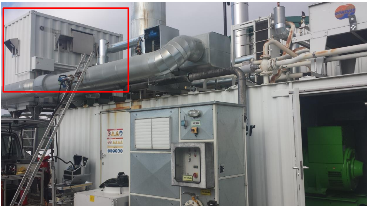
Abbildung 7: BHKW-Container mit Abgas-Nachverbrennung (rote Markierung) während eines Messvorgangs (Bildquelle: Tappen, LfL)
