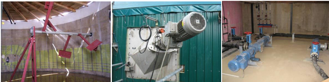
Abb. 18: Langsamlaufendes Axialrührwerk; Foto: N. Marschall,
